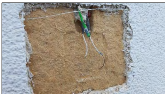
Abbildung 42: Geöffnete Messposition P an der Variante N 2.3 (heller Putz) nach dem Messzeitraum. Optisch ist kein Pilzmyzel erkennbar.
