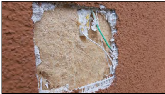
Abbildung 44: Geöffnete Messposition P an der Variante N 2.6 (dunkler Putz) nach dem Messzeitraum. Optisch ist kein Pilzmyzel erkennbar.
